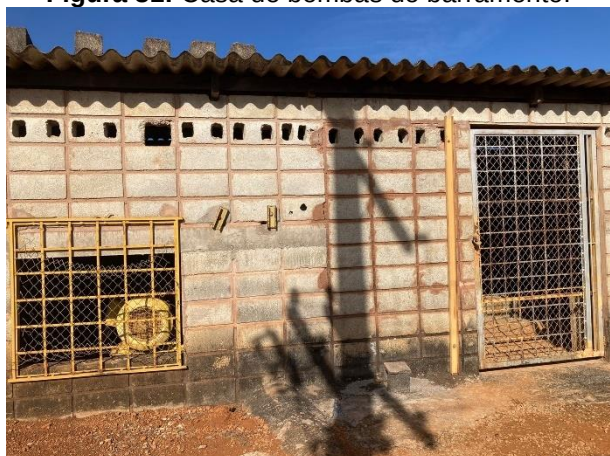
Figura 31: Casa de bombas do barramento.
