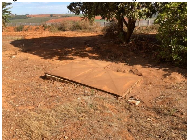
Figura 16: Caixa Separadora de Água e Óleo 01.
