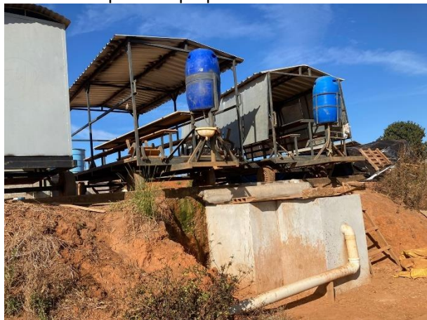
Figura 27: Caixa Separadora de Água e Óleo da pista de preparo de calda.
